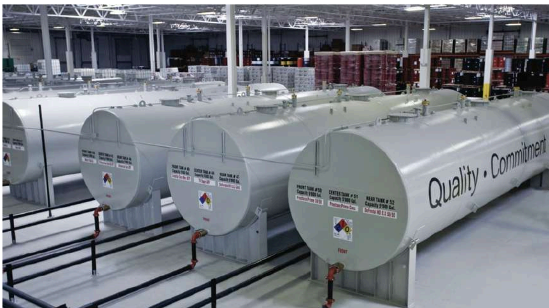
Highland (dochteronderneming van Terravest) bovengrondse stalen opslagtanks. Bron: ispfuelsystems.com
